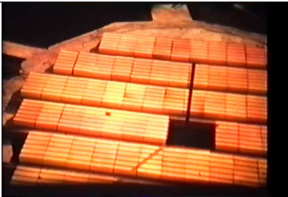
Le pignatte in attesa del getto per la realizzazione del solaio a pavimento del piano seminterrato: si osserva la predisposizione per il passaggio della colonna a supporto del telescopio, il cui asse è individuato da un palo
