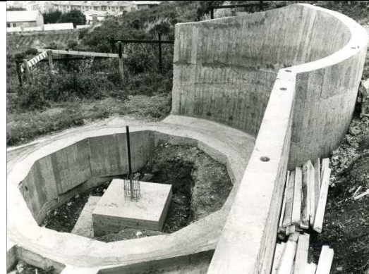
Il plinto di fondazione della colonna deputata al sostegno dello strumento principale, volutamente realizzato senza collegamenti alle altre strutture
