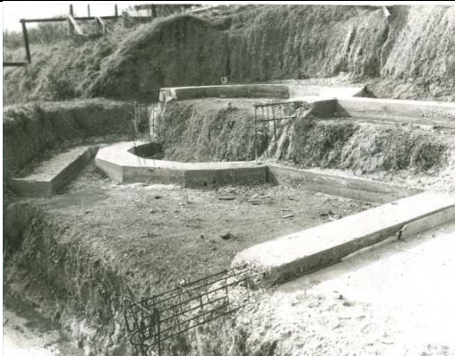
Le fondazioni in calcestruzzo armato parzialmente realizzate: si nota la conformazione acclive del sito e la presenza di barre di armatura del tipo "tondo liscio", riconoscibili dalla presenza di ganci terminali per migliorare l'ancoraggio alla matrice di calcestruzzo.
