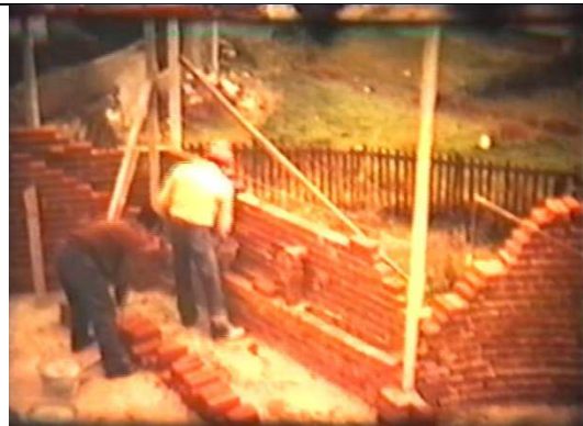
La realizzazione dei muri perimetrali al piano seminterrato. Nelle zone rettilinee essi vengono realizzati con doppia parete con spessori pari al lato corto del laterizio e camera d'aria interna mentre nella zona circolare vengono realizzati a parete unica con spessore pari al lato lungo del laterizio.
