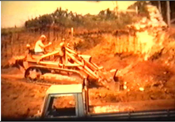
Gli scavi per la sistemazione del sito: l'uomo sulla ruspa potrebbe essere Giulio Ottonello
